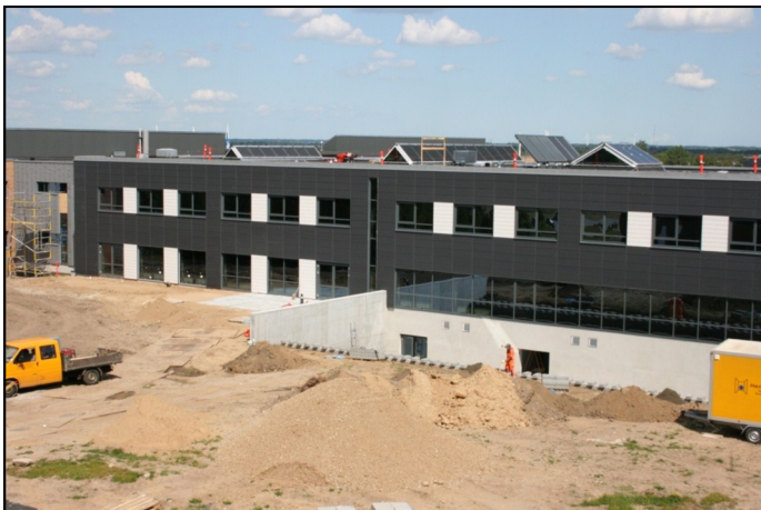
Ny facade mod vest, solfanger og solceller på tag
